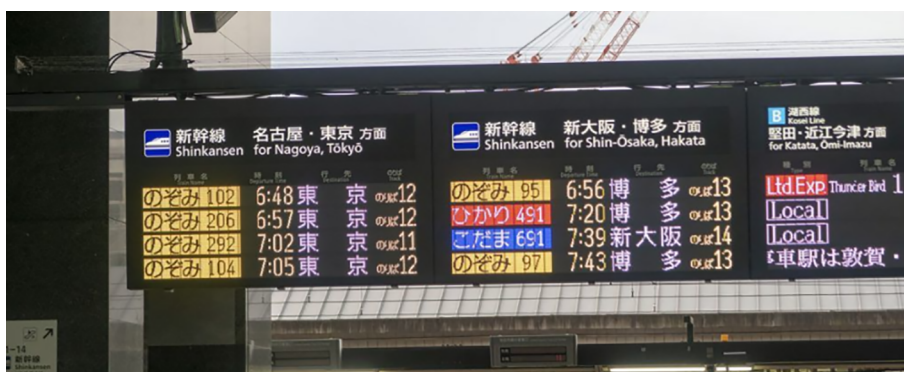
Figura 9. Panel de señalización
